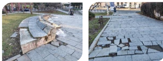
Poškodená dlažba, bariéry na chodníkoch a zanedbaný mobiliár na námestí. Zdroj:
