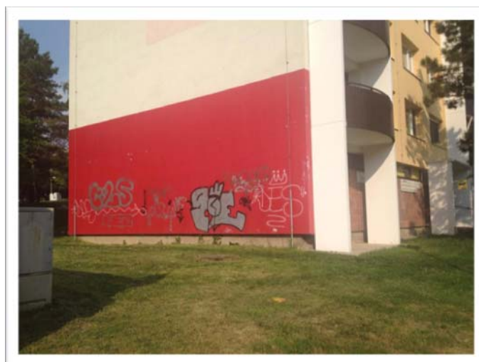
Obrázek 5: Graffiti na fasádě panelových domů
